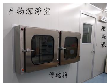
生醫材料 GMP 工廠無塵室
